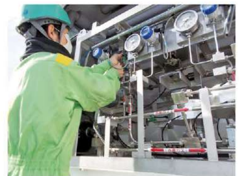
▲水素ステーションの検査
